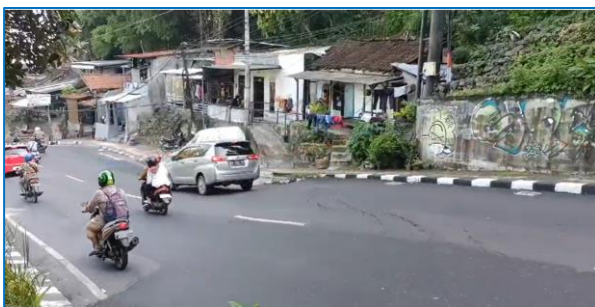
Gambar 2 Lokasi Longsoran Jalan Gombel Lama Semarang Yang Terdeformasi
